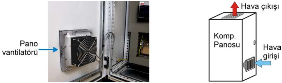
Görsel 9.29: Pano vantilatörü ve kompanzasyon panosunun havalandırılması
