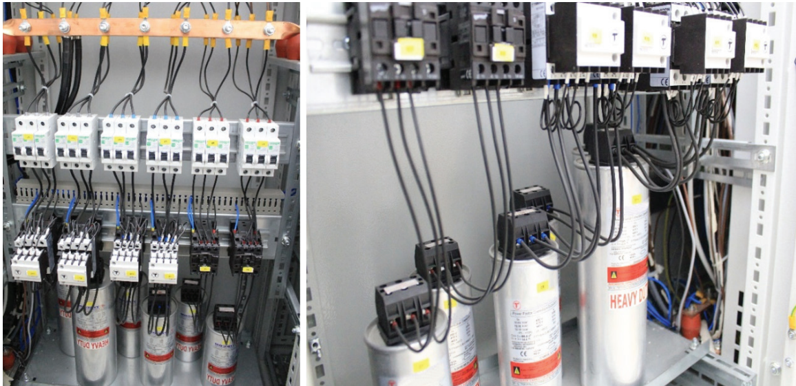
Görsel 11.7: Kompanzasyon panolarında kondansatörlerin bağlantısı
