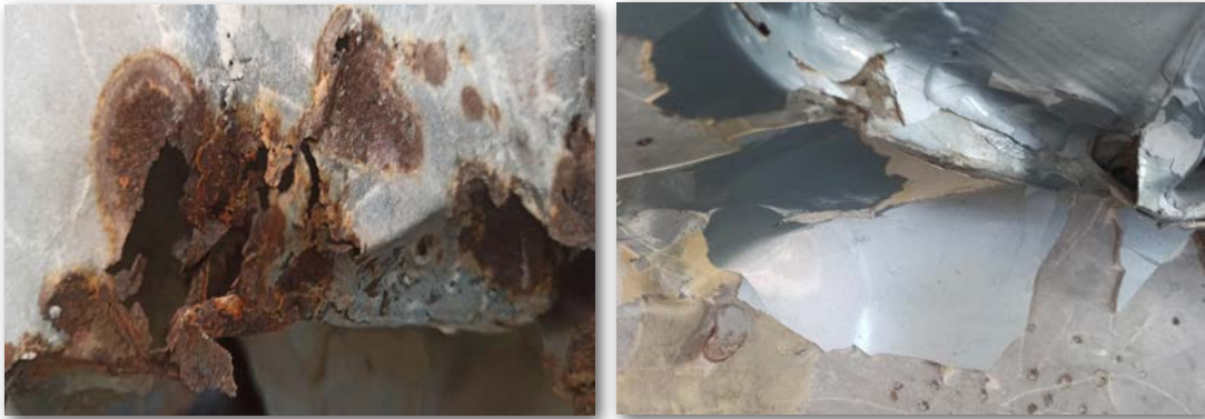
Görsel 7.15: Korozyona uğramış malzeme
