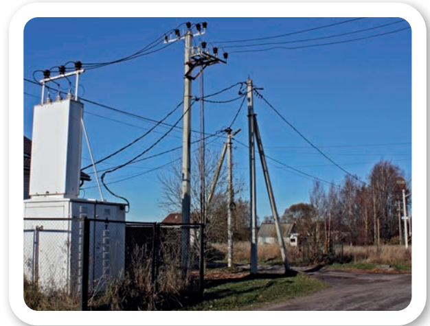
Görsel 18.2: Şehir şebeke elektrik dağıtımında kullanılan trafolar
