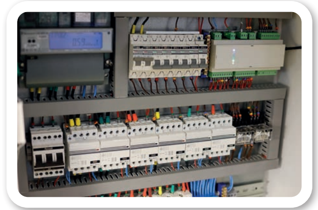
Görsel 17.13: Güç tesisatı elemanlarının bulunduğu bir pano
