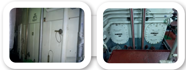
Görsel 15.1: F/O settling ve DO servis tank
