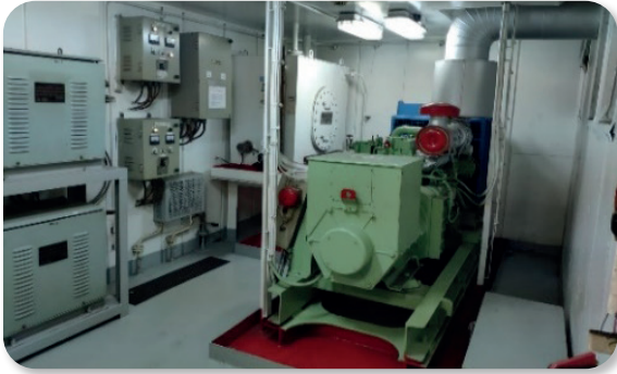
Görsel 1.40: Acil durum jeneratör odası
