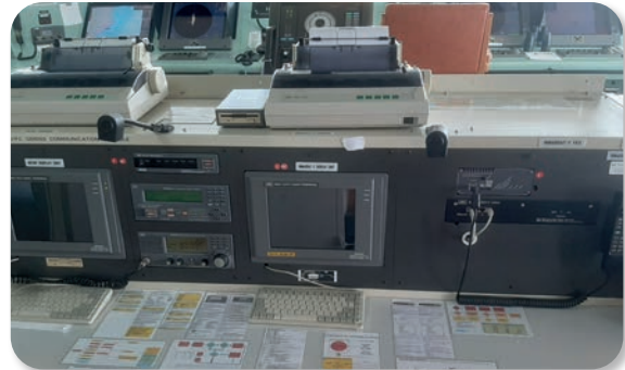
Görsel 1.71: Telsiz kamarası
