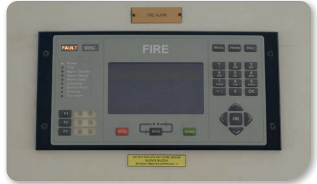
Görsel 3.2: Yangın alarm kontrol paneli
