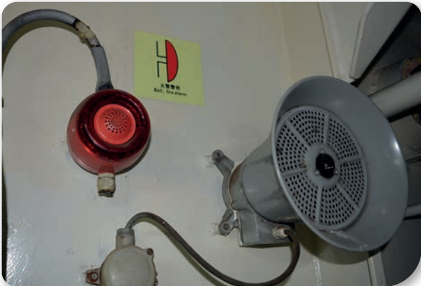
Görsel 3.5: Alarm sireni
