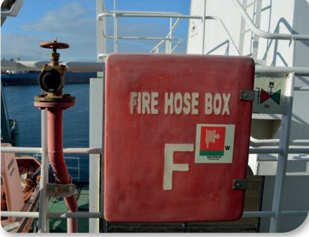
Görsel 3.13: Yangın dolabı ve vanası
