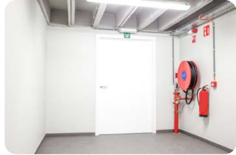
Görsel 1.6: Depoda bulunan yangın ekipmanı
