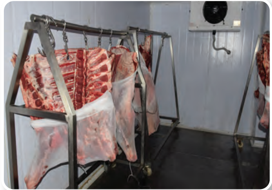
Görsel 3.37: Soğuk hava deposu
