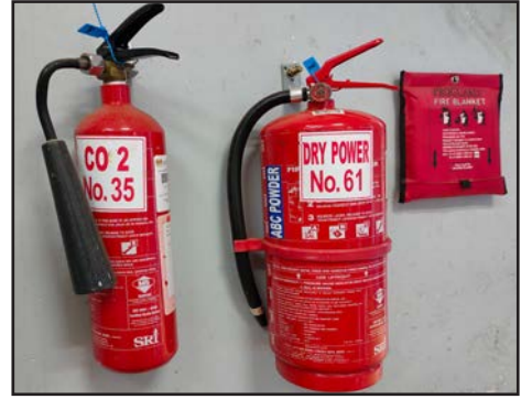
Görsel 1.9: Karbondioksit yangın tüpü
