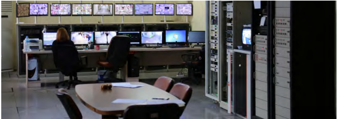
Görsel 2.14 : Bakırköy Açık Cezaevi kontrol merkezi
